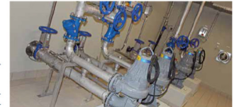
DIE KLÄRANLAGEN IN AACHEN (OBEN) SOWIE HOSCHIED IN LUXEMBURG (UNTEN) SIND NUR ZWEI VON 400 ANLAGEN, IN DENEN TECHNIK DER FIRMA ZAHNEN ZUVERLÄSSIG ARBEITET.
