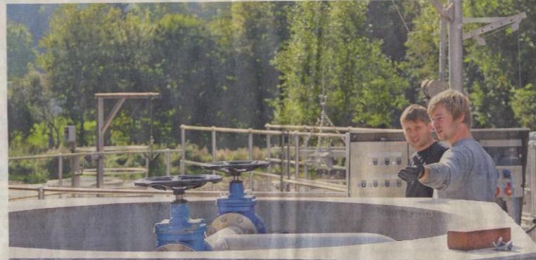
Armin Thelen und Michael Hansen (von links) kümmern sich um den reibungslosen Ablauf an der Eifeler Kläranlage in Habscheid-Holnich. Ihr Arbeitgeber, die Zahntechnik aus Arzfeld, ist Spezialist für Klär- sowie Biogasanlagen und legt Wert auf ein gutes Betriebsklima. FOTO: PRIVAT
